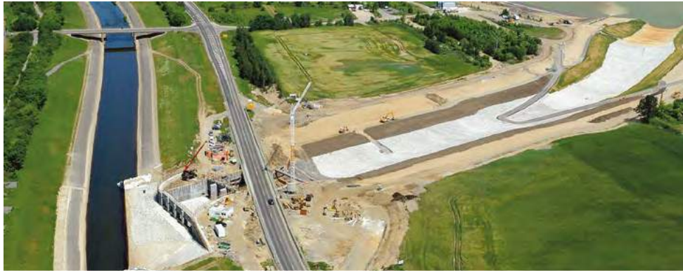
Hochwasserentlastung Weiße Elster in den Zwenkauer See
